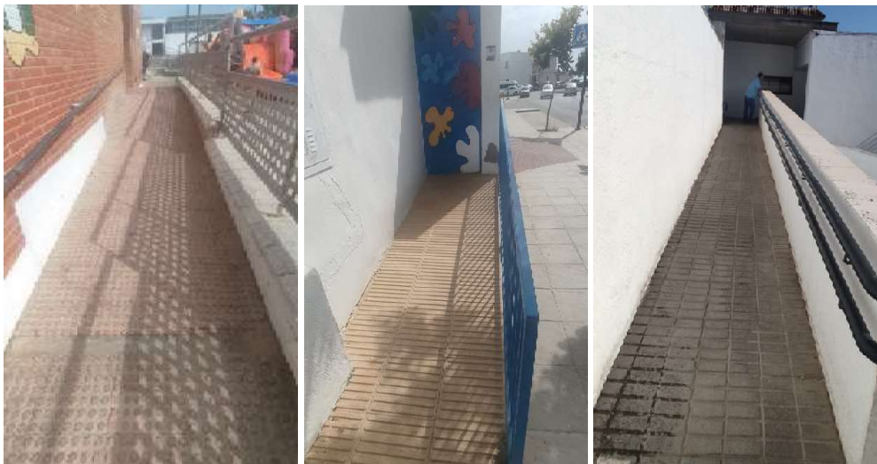
CEIP Las Erillas, Centro Infantil 8 de Marzo y Centro Guadalinfo, en Aznalcollar. Se debe disponer de una rampa incorporada y perfectamente integrada con las escaleras. No obstante, no debe olvidarse resolver la barandilla propiamente dicha como protección ante el desnivel.
